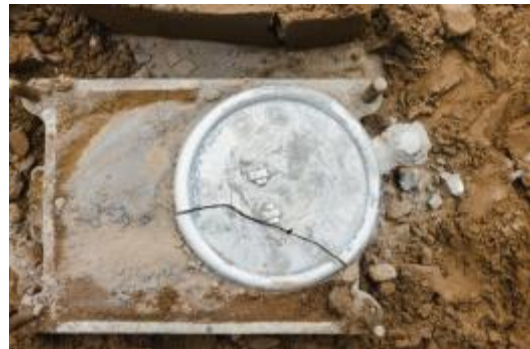
그림 24. 균열에 의한 파손
