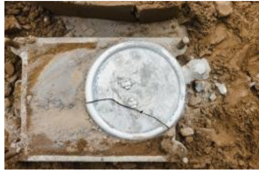
그림 24. 균열에 의한 파손
